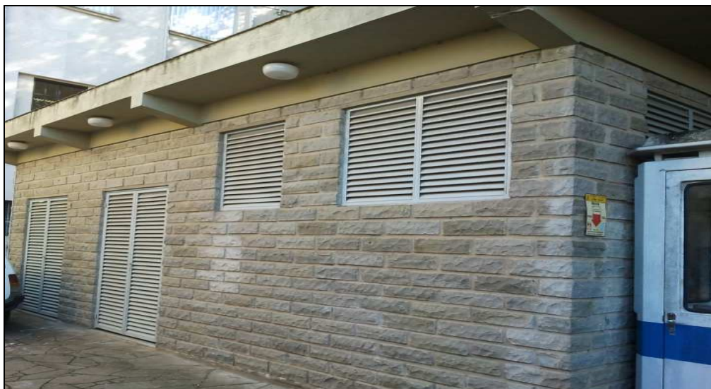
Figura 9 – Subestação de Energia Elétrica com paredes revestidas por pedra de talhe de basalto
