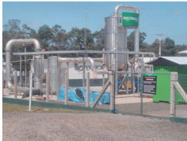
Figura 3 - Usina biotérmica- CRVR
