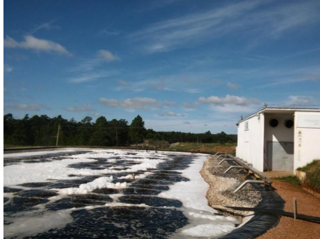
Figura 1- Lagoa de tratamento de chorume
