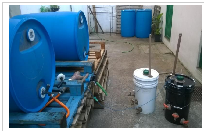
Figura 5 – Reservatórios de esgoto bruto
