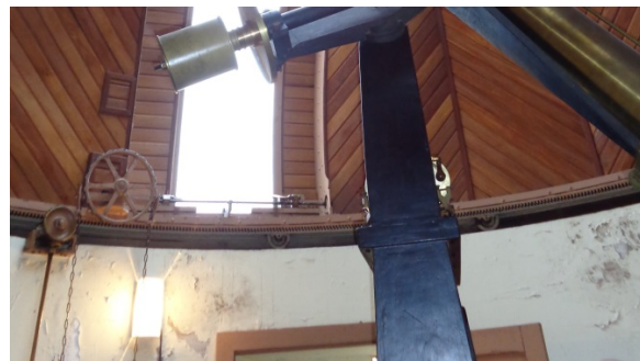
Figura 42 - Existe infiltração na parede interna da cúpula
