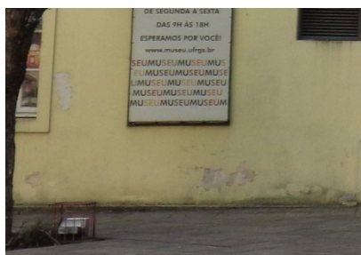
Figura 34 - Exemplo da pintura das paredes descascando
