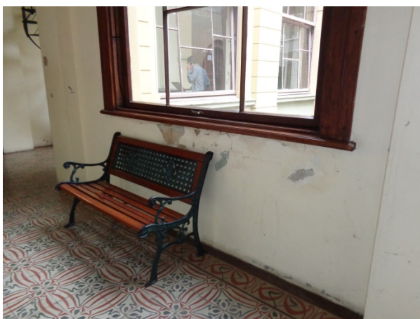
Figura 32- Exemplo de parede interna com o reboco descascando
