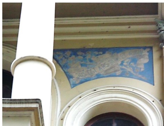
Figura 35 - Pintura abaixo do frontão da entrada principal
