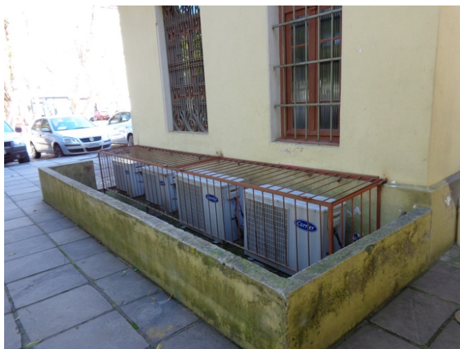
Figura 13 - Condicionadores de ar
