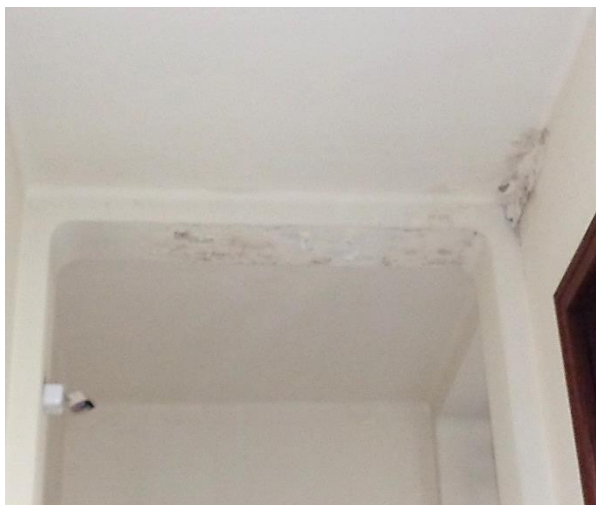
Figura 34 - Exemplo de infiltração
