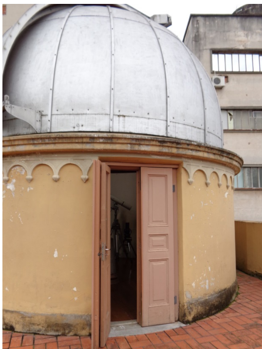
Figura 43 - A pintura da parede da cúpula está descascando e escura junto ao chão
