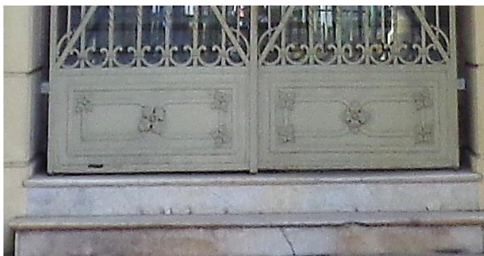
Figura 38 - Portão da entrada principal com ponto de ferrugem
