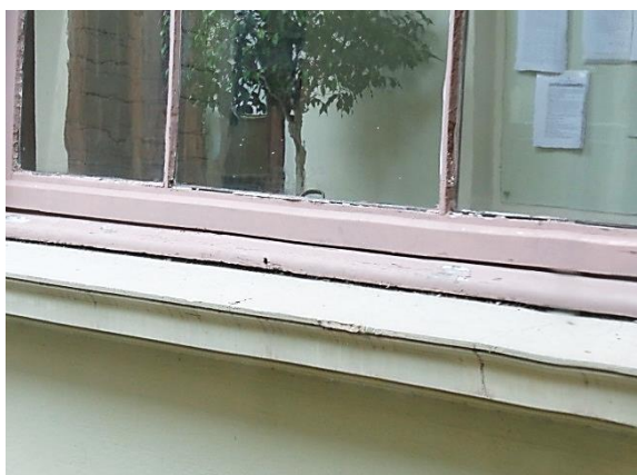
Figura 36 - Exemplo de esquadria de madeira necessitando de restauração
