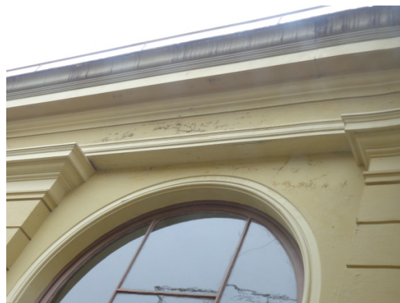
Figura 33 - Exemplo de pintura da parede externa necessitando de restauração
