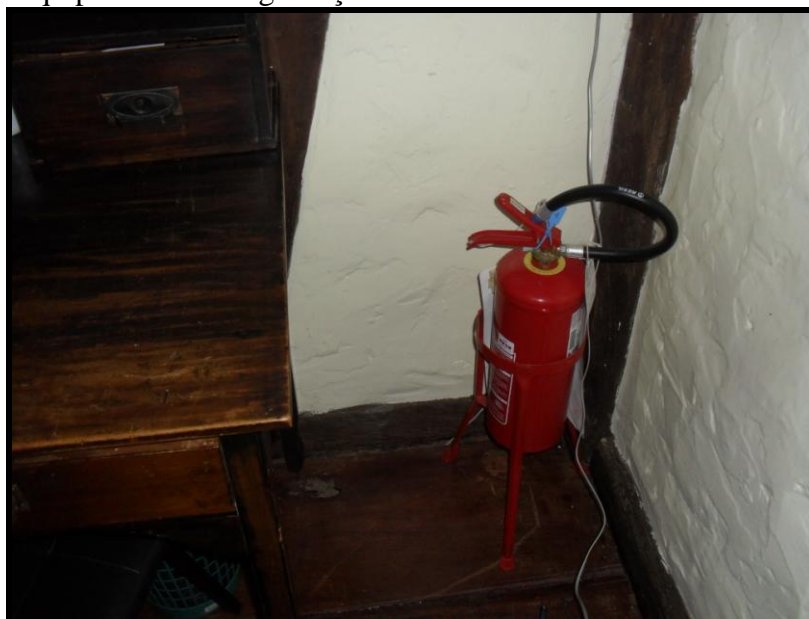
Figura 39 - Equipamento de segurança - extintor de incêndio no escritório (MHMDI).
