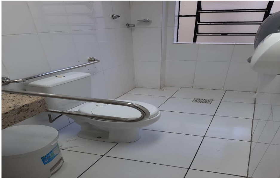
Figura 20 - Sanitário Acessível - Equipamentos de apoio ao vaso sanitário
