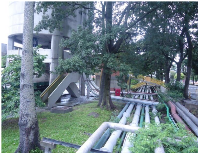
Figura 16 - Silo de armazenagem de cinzas volantes.
