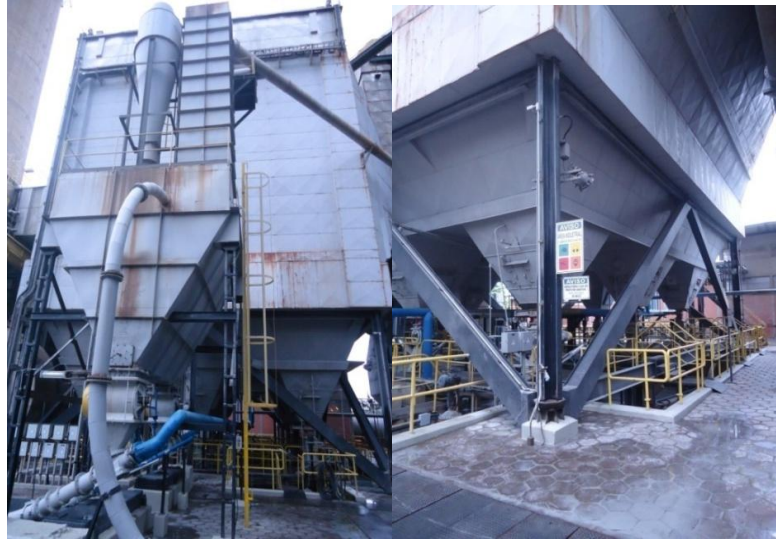
Figura 15 – Precipitador eletrostático e detalhe da base cônica quadrada
