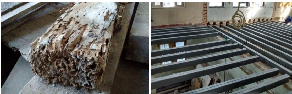
Figura 22 – Madeiramento com cupim (esq.) e substituição por vigas de aço (dir.)
