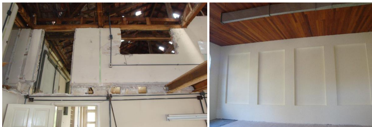
Figura 27 – Aberturas não utilizadas desde a ampliação, presentes nas duas antigas laterais (esq.), vão fechados (dir.)
