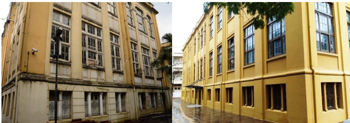
Figura 30 – Fachada deteriorada (esq.) e fachada restaurada (dir.)
