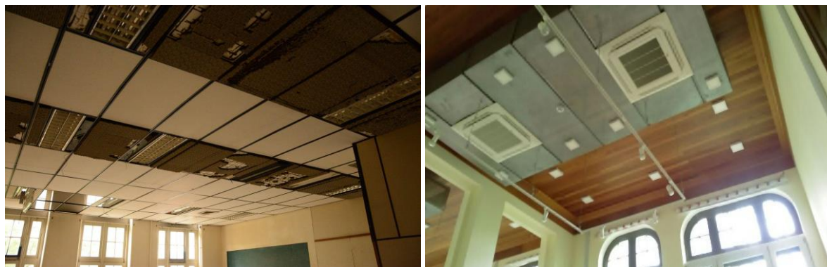
Figura 28 – Forro deteriorado (esq.) e novo (dir.)
