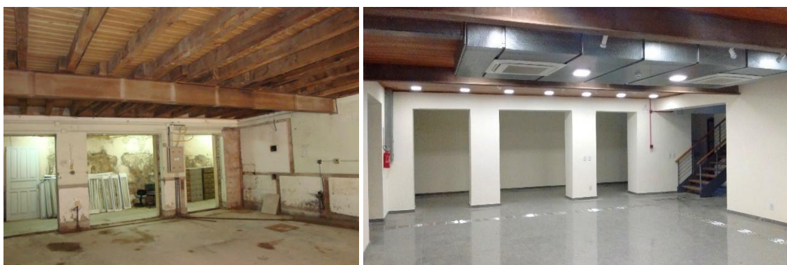
Figura 23 – Infiltrações nas paredes (esq.) e revestimento recuperado (dir.)
