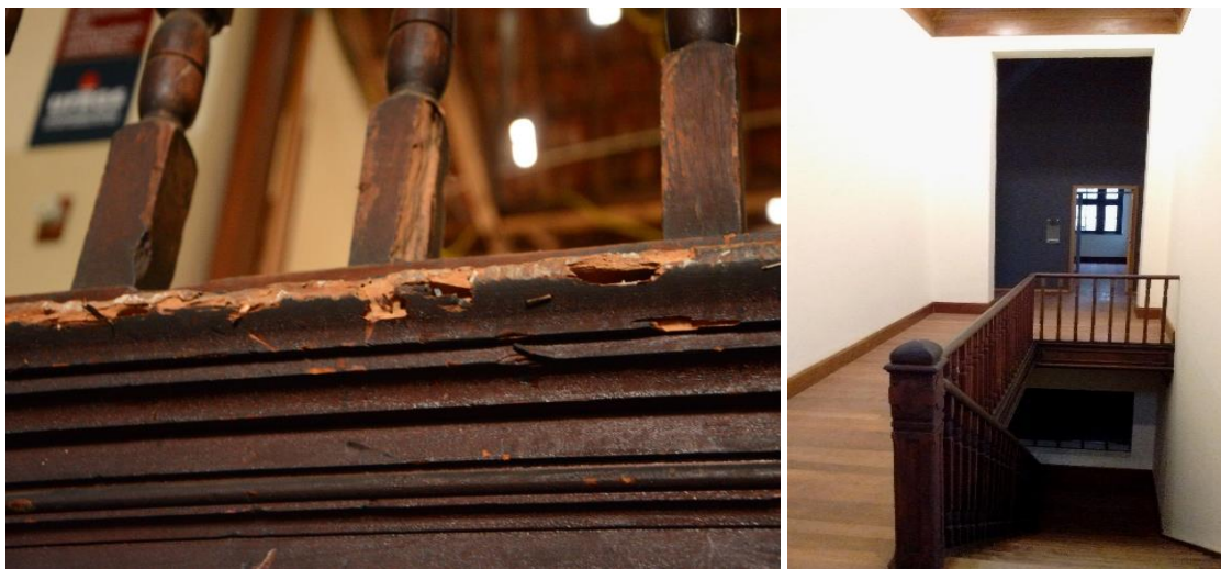
Figura 33 – Escada deteriorada (esq.) e escada restaurada (dir.)
