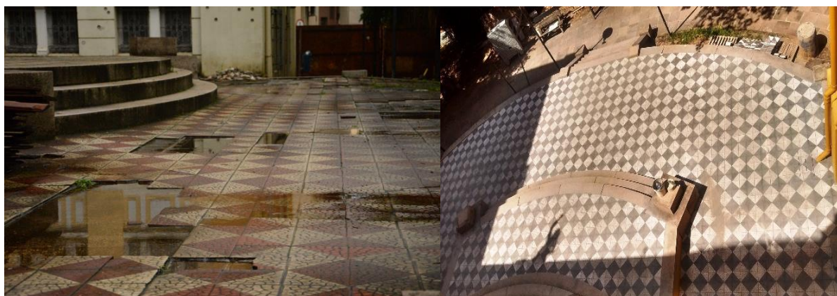
Figura 32 – Piso externo danificado (esq.) e substituído (dir.)
