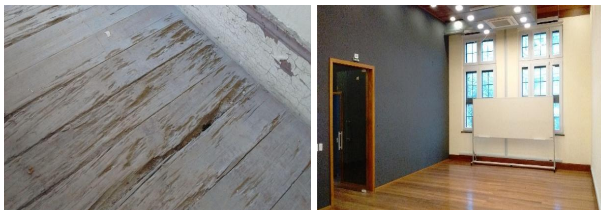
Figura 29 – Piso danificado (esq.) e piso novo (dir.)
