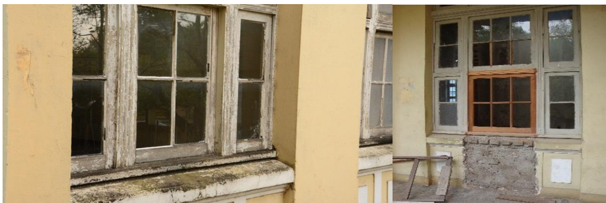
Figura 31 – Esquadrias danificadas (esq.) e restauradas (dir.)
