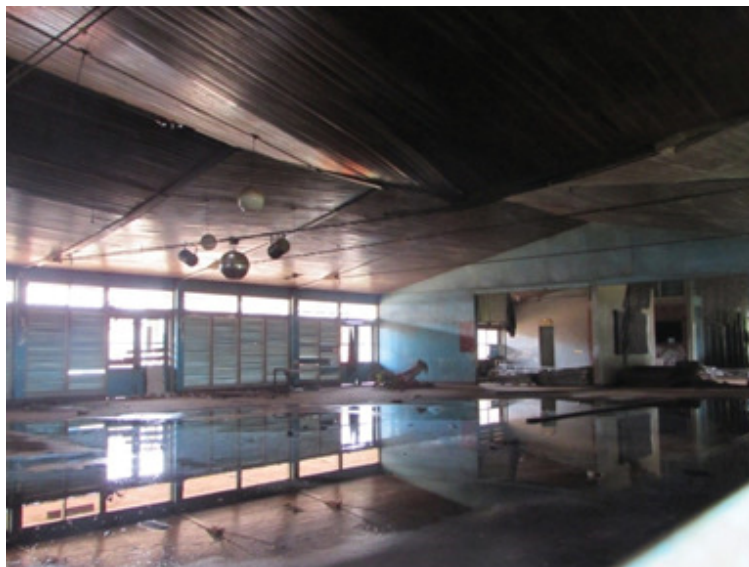
Fig. 5 – Manganês Esporte Clube (2015), que desmoronou parcialmente em janeiro de 2016. Acervo do Laboratório de Estudos do Patrimônio, EAU/UFF.
