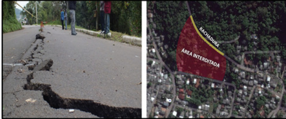
Figura 4: Registro de uma rachadura do solo em um setor de risco mapeado ocasionando na interdição de parte de uma área Fonte: Jornal NH, Edição do dia 23/07/2015.Foto de Marcelo Kervalt/ GES – Especial, Adaptado pelos autores
