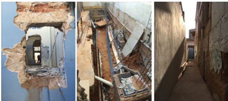
Figura 3 – Obras emergenciais na lateral esquerda. Fonte: Dossiê do Prêmio Rodrigo Melo Franco, (IPHAN, 2017)
