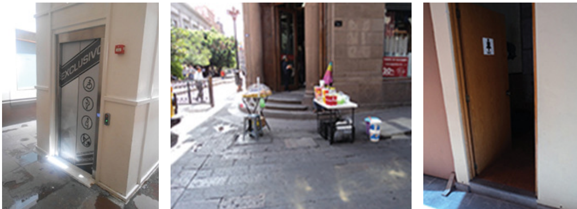
Desniveles que impiden el acceso autónomo
